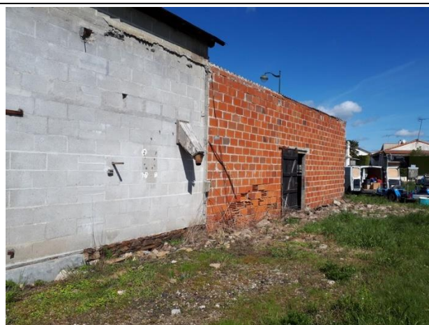
Photographie 6 : Vue des débris de démolition au sol
