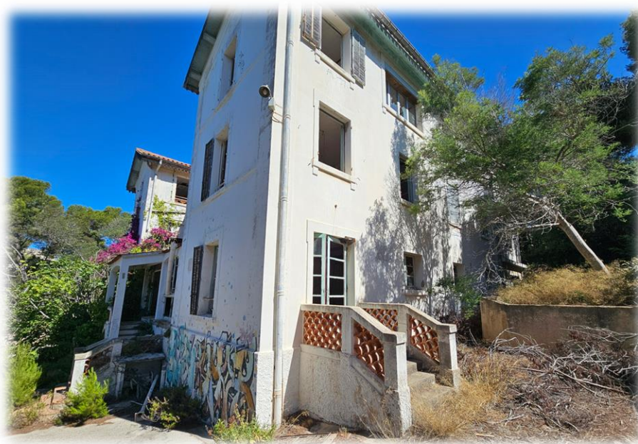
Figure 14 : Bâtiment désaffecté en état de dégradation avancée, partiellement recouvert de végétation ornementale (bougainvilliers) et entouré d'un couvert végétal clairsemé.
