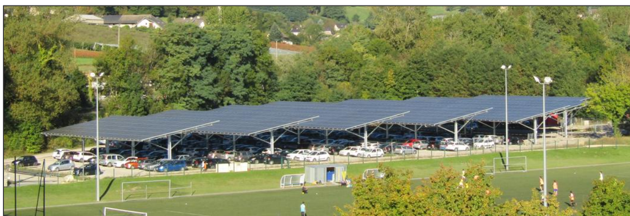
Figure 8 : photographie des ombrières installées sur la ZAC de Savoie Technolac
