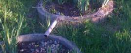
Les bassins en 2016 : l'eau n'est pas visible en surface des filtres plantés car le niveau d'eau est en dessous de celui des matériaux.
