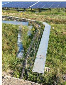
Chemins de câbles
