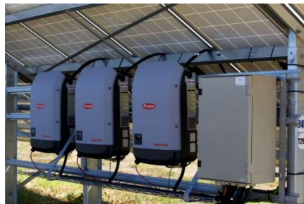
Onduleurs et tableaux électriques
