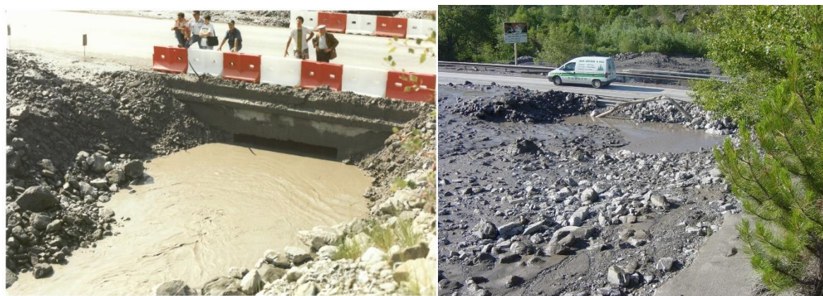
fig. 24 : Dépôt de matériaux au niveau du pont de la RN94 lors de la crue de 1995 (à gauche) et 2005 (à droite)
