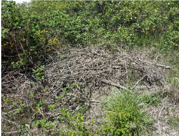
Tas de branchage sur la digue en rive droite du Dévezet
