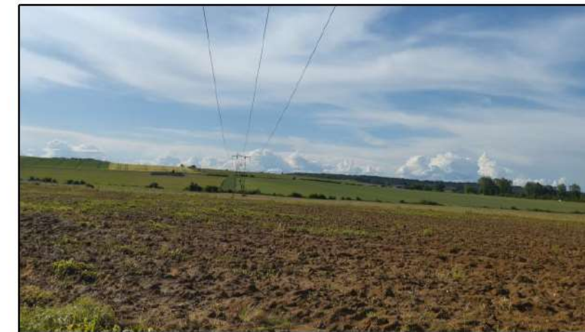
2 – Prise de vue de la ligne aérienne existante sur le secteur agricole au nord du poste de Gy
