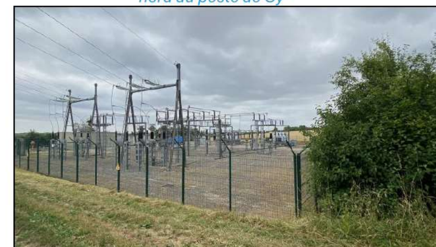
4 – Poste de Gy
