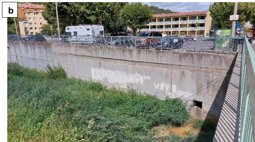
Figure 1 : Murs en mauvais état
