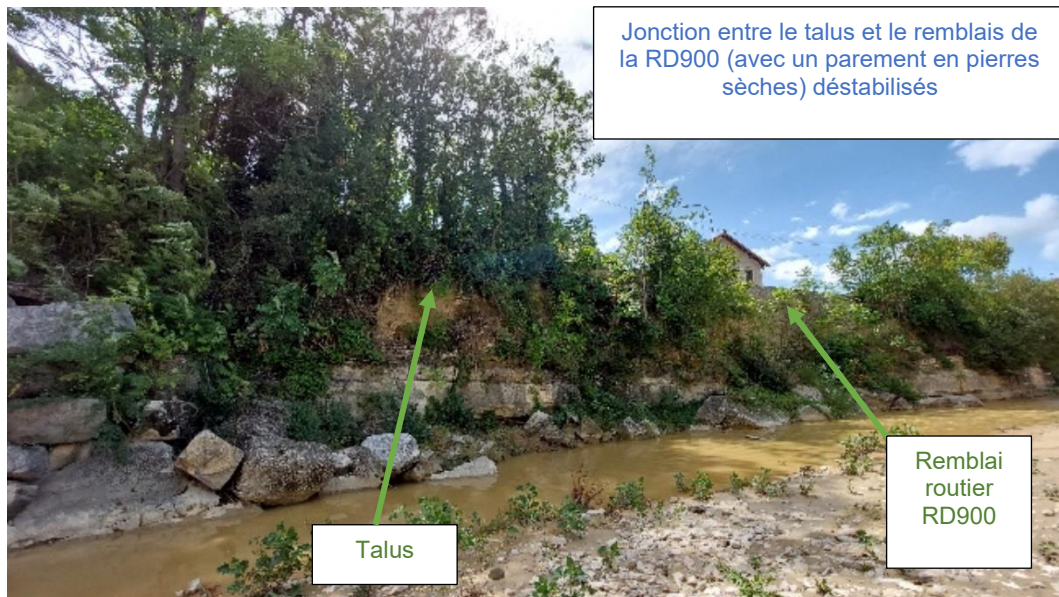
Figure 2 : Talus raide et érodé, déstabilisation des enrochements limitrophe à la RD900
