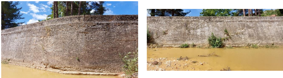
Figure 6 : Fissures présentes dans le mur du camping
