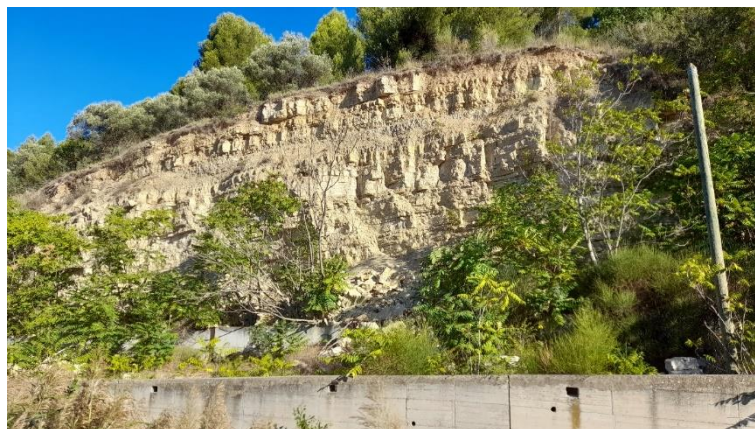
Figure 3 : Erosion de l'escarpement rocheux situé en face du parking 1
