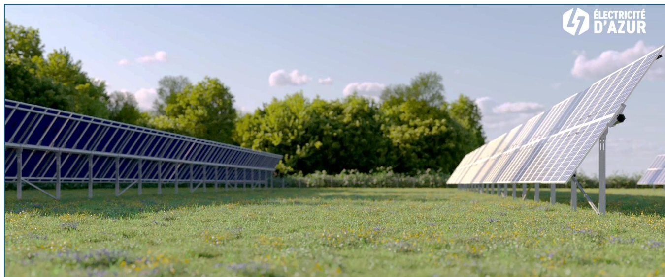
Figure 7 : Trackers (Source : Electricité d'Azur)
