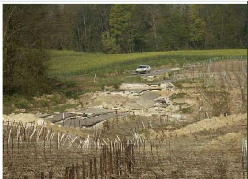
Figure 37 : Exemple de dégâts occasionnés sur la route de Boursault à Vauciennes (Source : Préfecture de la Marne)
