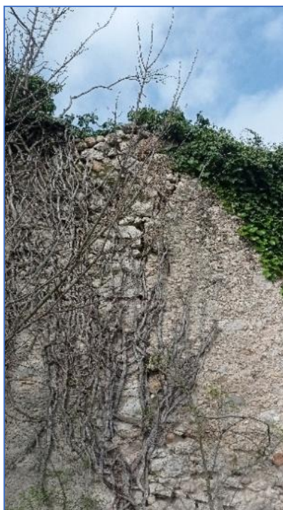
Figure 16 : Bâti avec anfractuosités dans les murs
