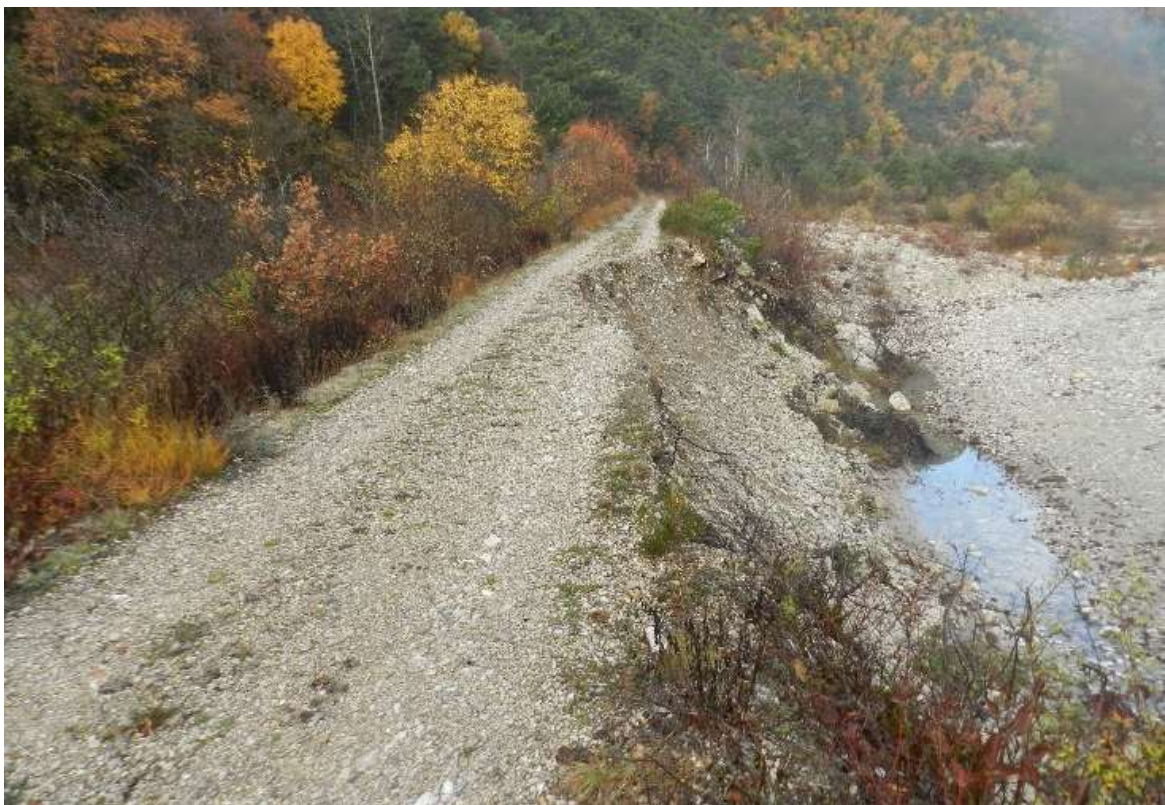
Dégradation de la partie amont de la digue Octobre 2024
