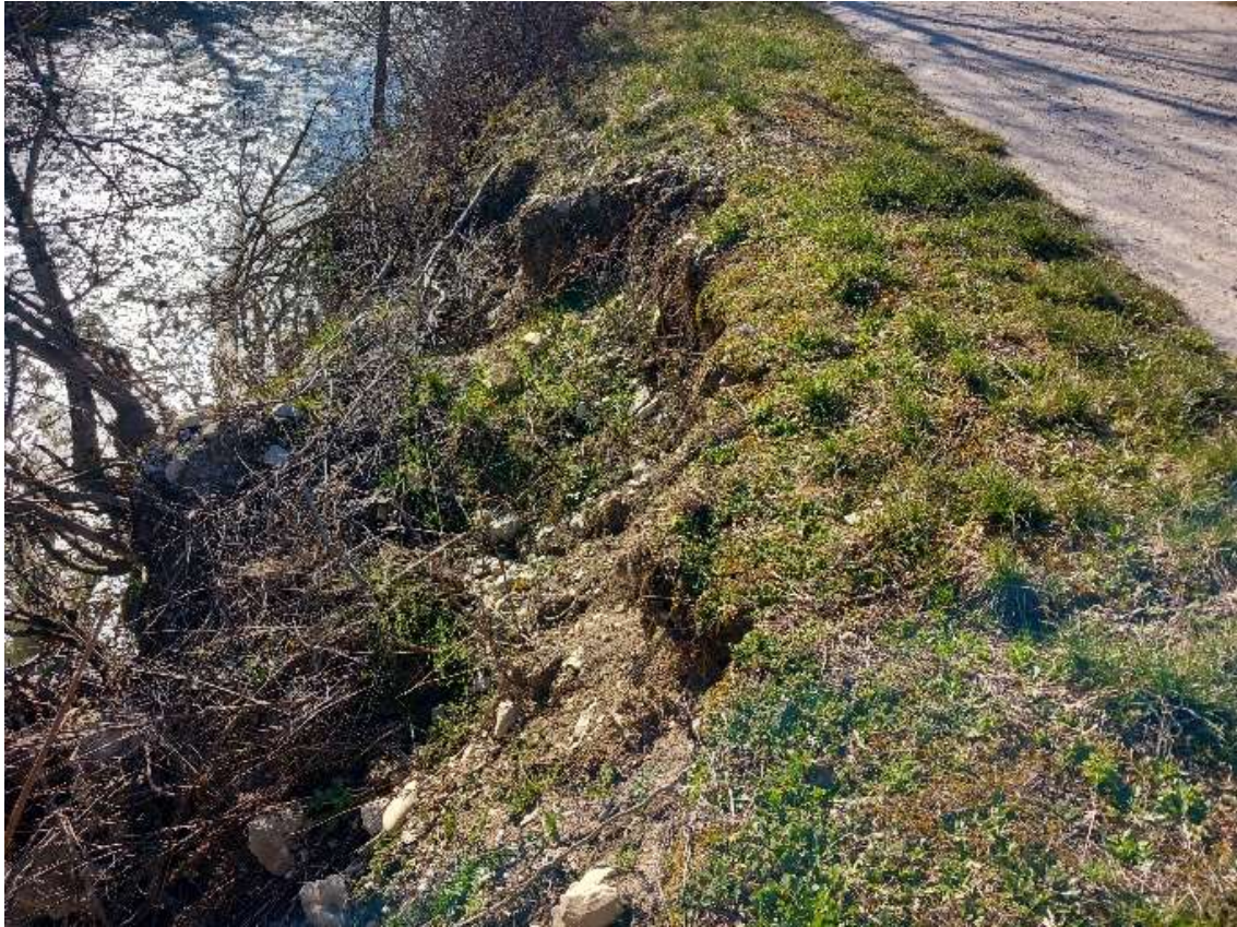
Erosion de digue à proximité du pont de la R28
