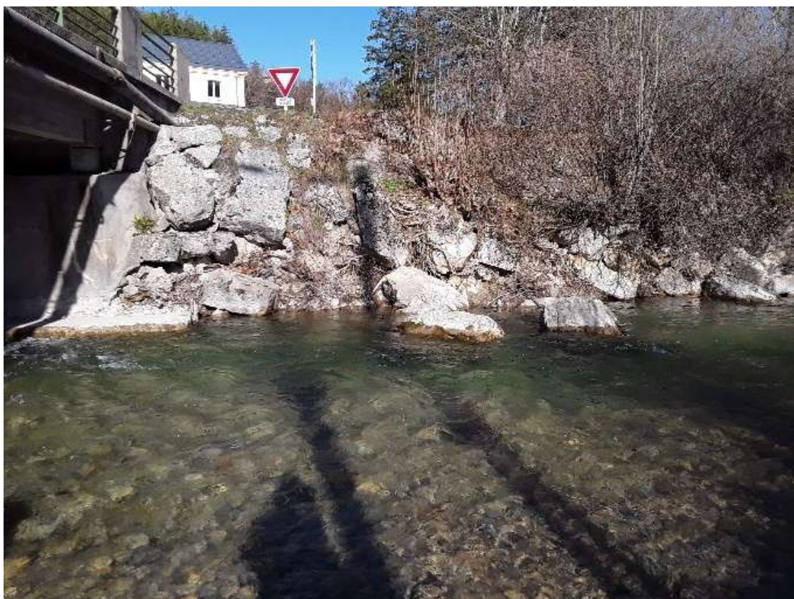
Dégardation de l'enrochement d'entonnement du pont de la RD28 – Avril 2024
