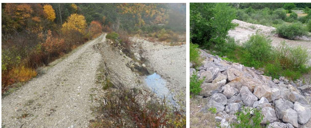
Figure 3: Erosion de la digue suite à la crue de 2014 (SMIGIBA, 2014) et enrochement de protection mis en œuvre au même endroit (AMETEN, 2022)
