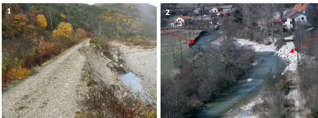
Figure 9 : 1 – Erosion de l'amont de la digue de la plaine des Levas (SMIGIBA, 2014) et 2 – Evolution morphologique du Grand Buëch en aval du pont de St-André lors de la crue de 2002 (SMIGIBA, 2002)
