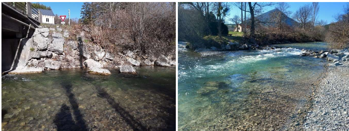
Figure 6 : Vue successive de l'encoche d'érosion en aval rive gauche du pont St-André puis du seuil (AMETEN, 2023)
