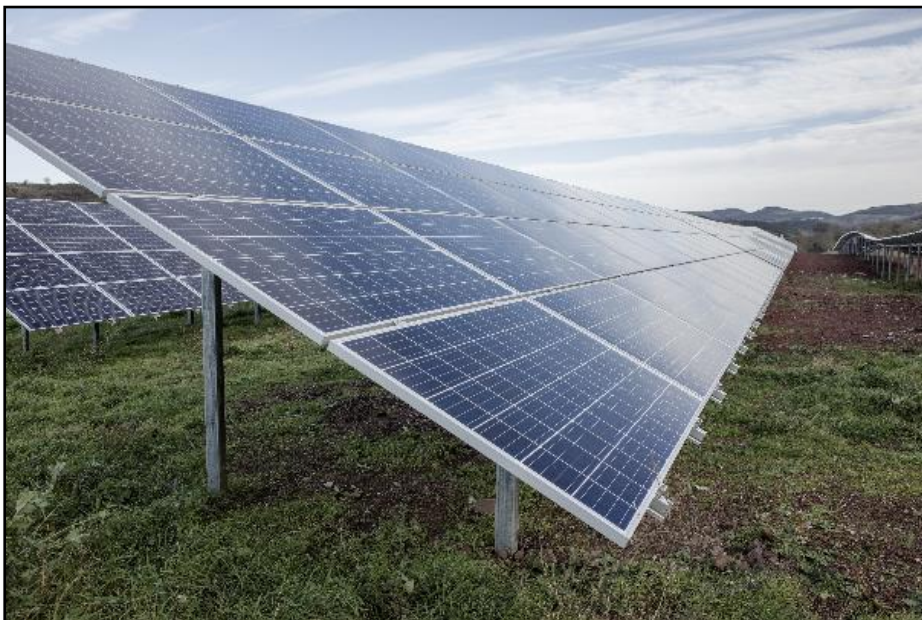
Photo 5 : Structures en pieux battus - Parc Solaire de Camares (12) – SDMD
