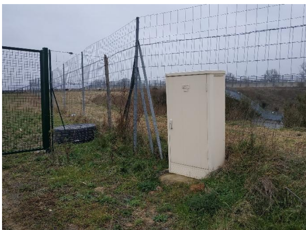
Figure 27 : Poste de livraison
