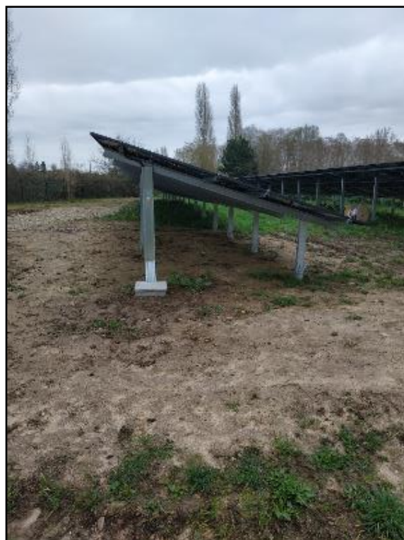
Figure 24 : Tables photovoltaïques avec structures en micropieux - Parc solaire de Soucelles - 299 kWc
