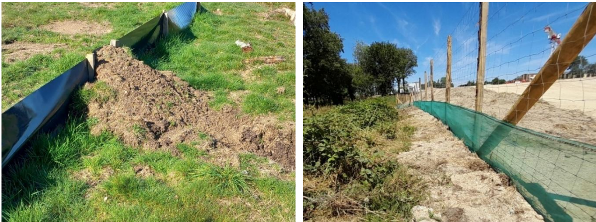
Figure 1 : Exemples de filets de protection pour limiter l'accès de la petite faune à un chantier (ENCIS Environnement)
