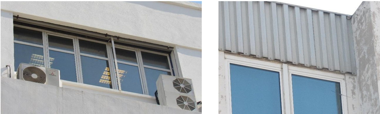
Figure 33 : Interstices entre les volets et le mur (à gauche) et arrière des plaques ondulées (à droite), A. BARATEAU © EODD 2024
