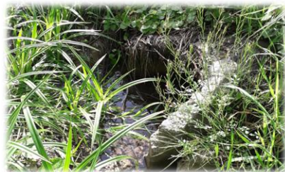
Buse sous voirie
