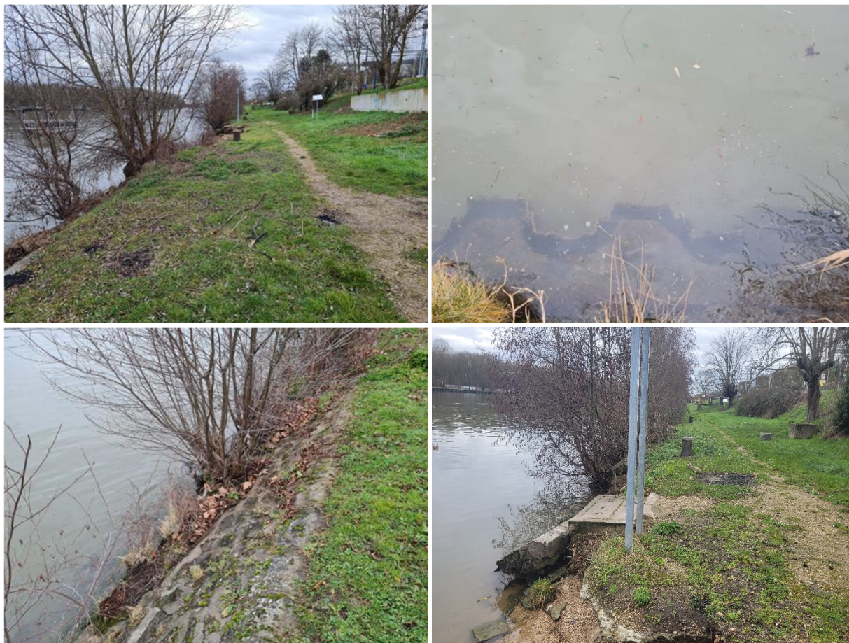
Photos 5 : état de la berge (ancien perré dégradé avec quelques aulnes)
