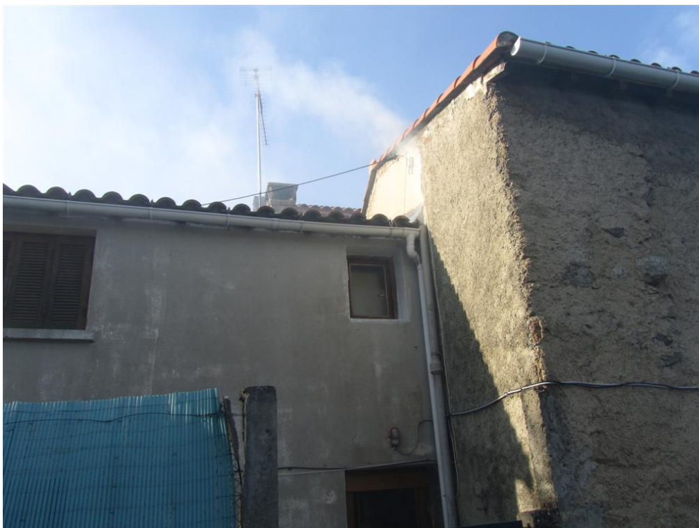
Illustration 6 : Tuyau d'une ancienne fosse septique
