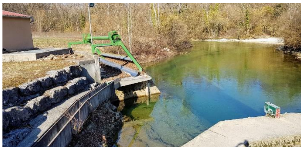
Figure 3 Prise d'eau de la centrale d'Artemare
