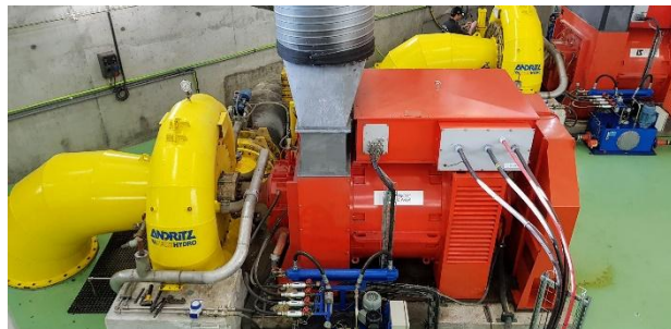
Figure 2 Turbine de la centrale d'Artemare
