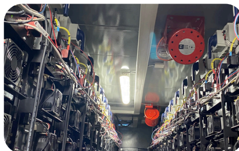
Exemple de système d'extinction d'incendie par aérosol
