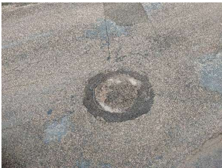
Figure 21: Regard EU52 bloqué par du bitume
