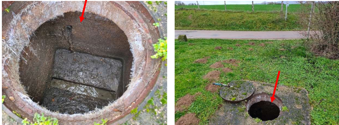
Figure 22: Racines et conduite regard EU1
