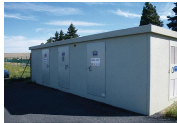
Figure 7 : Exemple de poste de livraison
