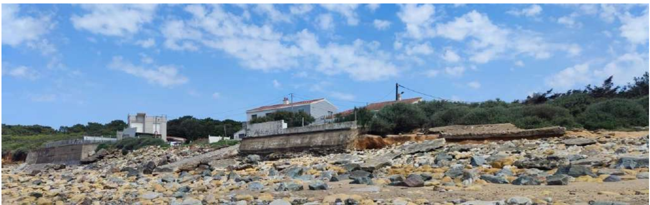
Figure 4 : Enrochement et bétonnage du littoral érodés à l'Anse de la République
