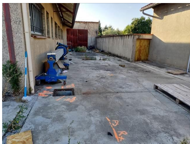
Limite sud du site : l'ensemble des tampons du réseau de collecte des eaux pluviales a été vandalisé et retiré
