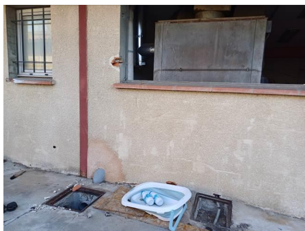
Vue de la chaufferie depuis l'extérieur
