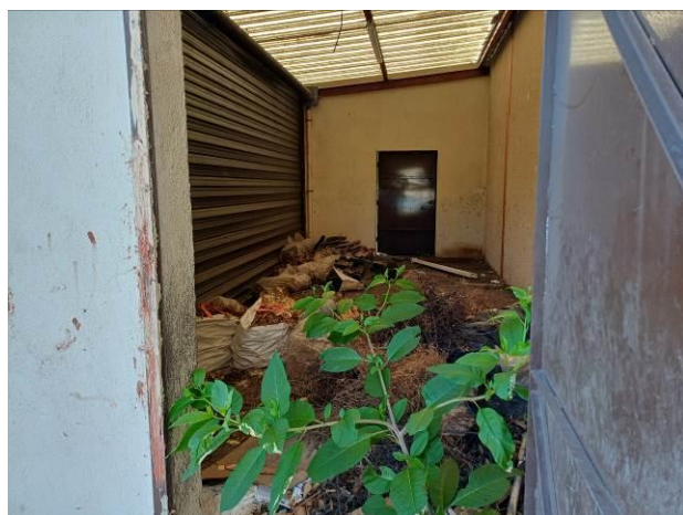
Dépôt de déchets vers dans la pièce n°2
