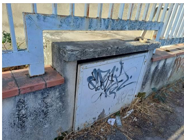
Ancienne arrivée de gaz de ville alimentant le site
