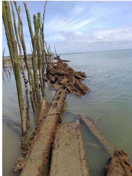
Prise de vue 12 h 48 le 27/05/2025 : prise de vue vers le Nord, partie de l'enrochement en bon état, 23 minutes après la basse mer.
