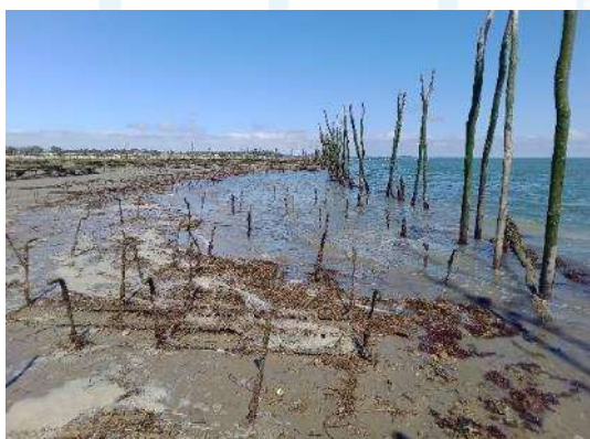
Prise de vue à 13 h 47 le 31/03 : vue du Sud vers le Nord de la partie du bas de parc non exploitable, voisinant le tronçon d'enrochement affaissé.
