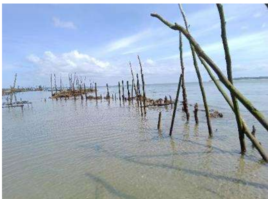
Prise de vue vers le Nord le 27/05 à 12h18 : enrochement fragilisé, qui s'est effondré côté chenal vers le bas du talus et par bas de la ligne de pignots
