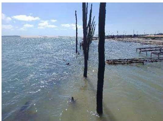
Prise de vue à 13 h 41 le 31/03, du Nord vers le Sud. Partie d'enrochement affaissée, se retrouvant sous l'eau à la basse mer (13 h 57 le 31/03)
