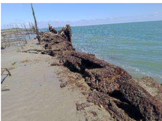
Prise de vue 13 h 53 le 31/03 du Sud vers le Nord : enrochement qui s'effondre vers le bas du talus
