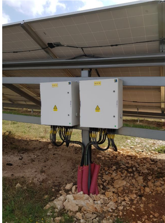
Figure 15: onduleur string (source TSE)
