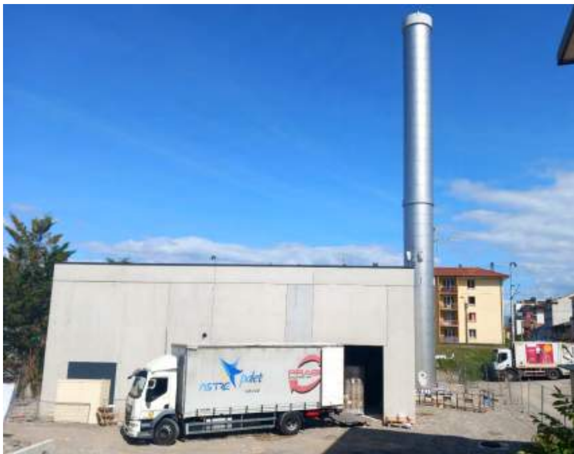
Figure 9 : Chaufferie gaz (Source : Améten, Mai 2025)
