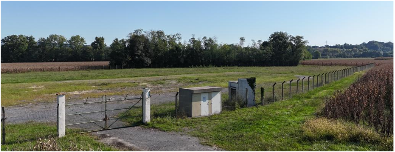
Figure 12: Positionnement du poste de livraison et vue du poste préexistant
