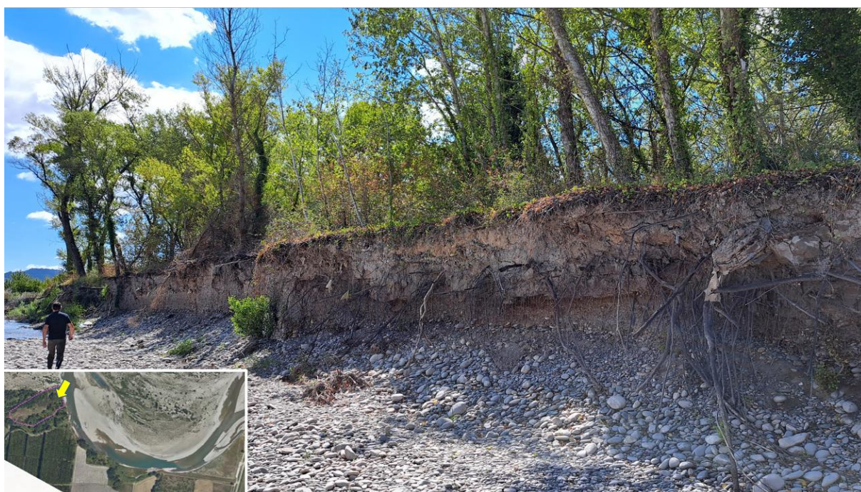
Figure 5 : Berge érodée au droit de la décharge, avant travaux
