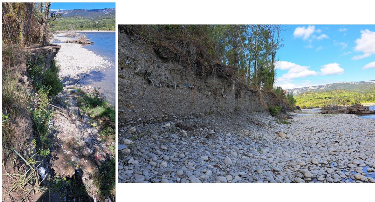
Figure 6 : Berge érodée au droit de la décharge, avant travaux
