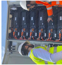
Batteries de stockage d'énergie (source: ZE Energy)
