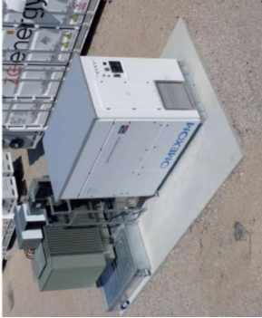
MV Skid installé par Ze Energy (source: ZE Energy)
