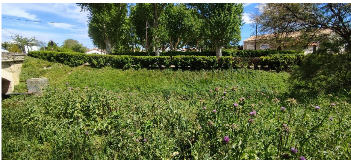
Extrémité sud de la Viredonne en mauvais état de conservation (Ruisseau de la Viredonne x Roselières et formations de bordure à grands héliophytes autres que les roseaux, EUNIS : C2.5 x C3.2)
