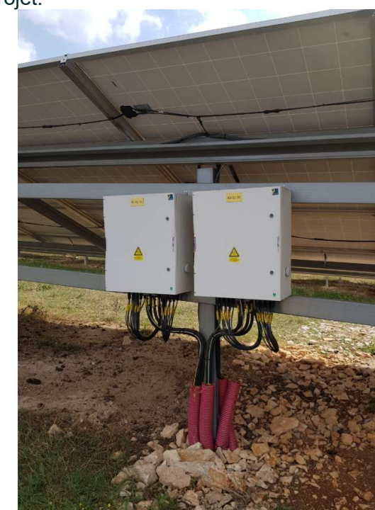
Figure 14: Onduleur string (source TSE)
