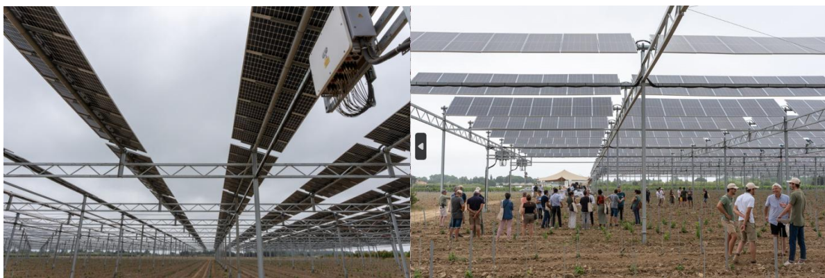
Figure 33 : Photographies de la structure agrivoltaïque sur notre site existant à Clairac 66 (Source : Sun Agri)
