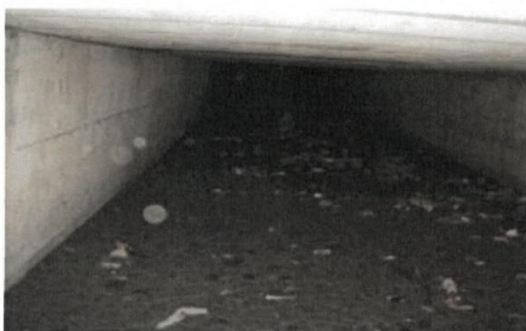
Figure 67 : Bassin enterré – Photo (Communauté Urbaine de Bordeaux, 2014)
