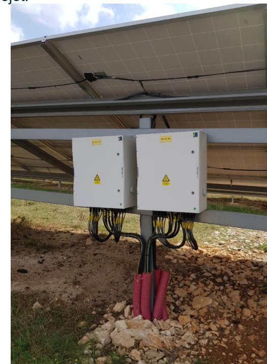
Figure 12 : onduleur string (source TSE)
