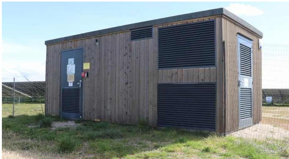
Figure 14 : Poste (source TSE)
