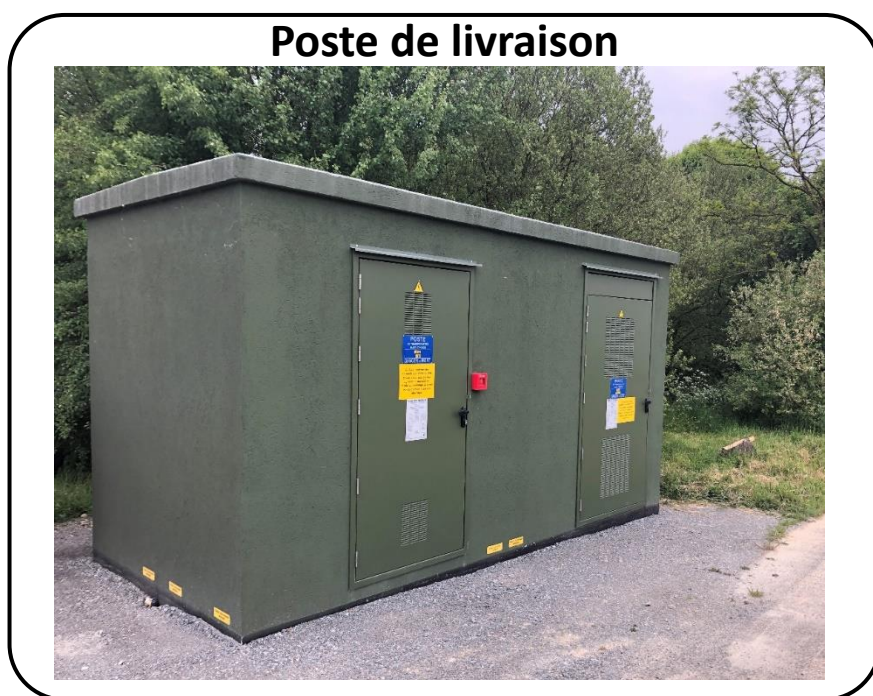
Figure 417: Exemple de poste de livraison
