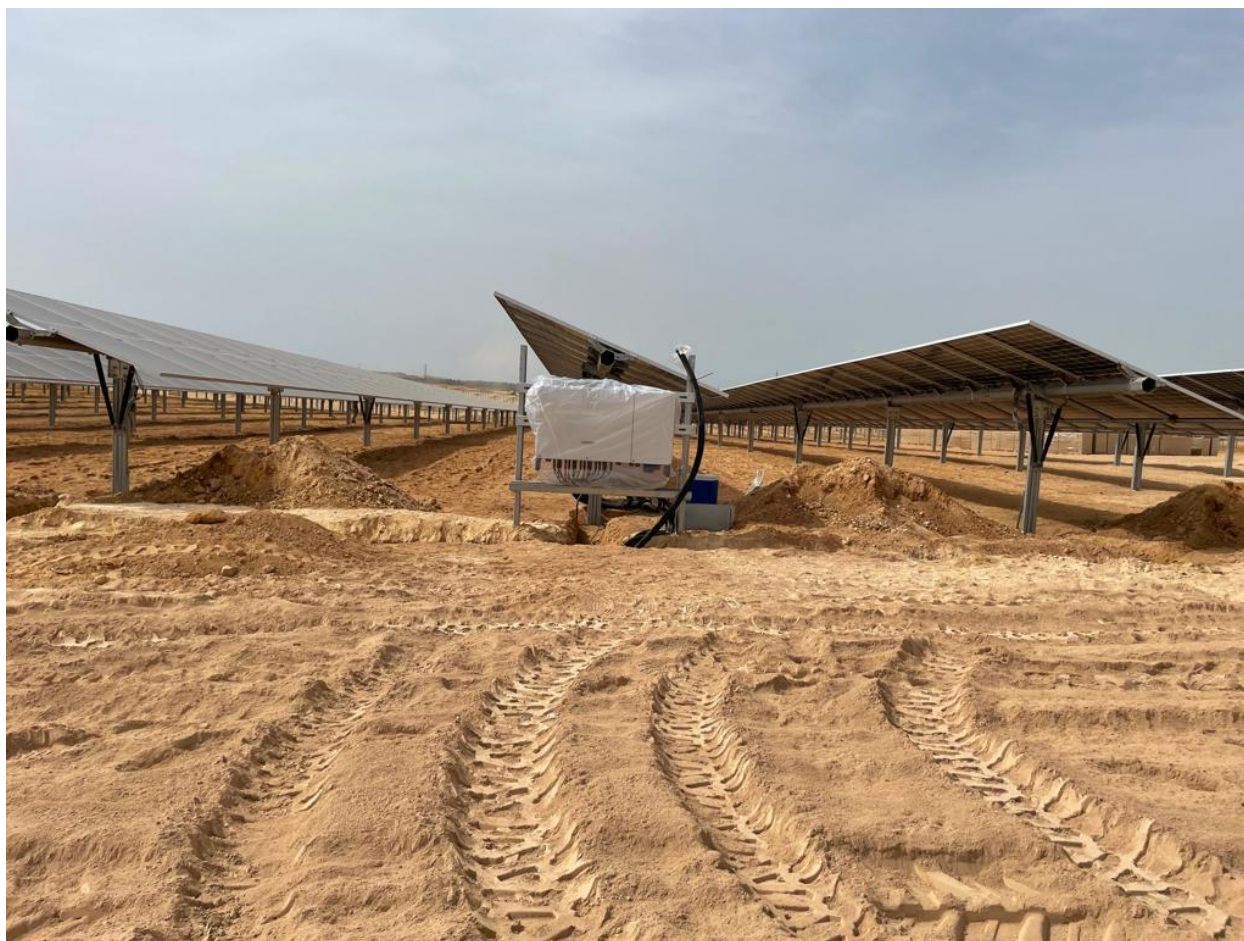
Figure 43: Onduleurs "strings" installés en bout de rangée (source : BayWa r.e.)
