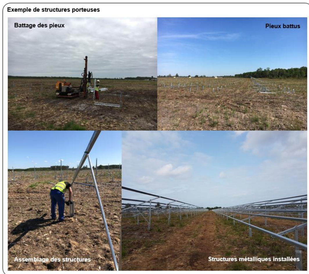
Figure 402 : Structures porteuses métalliques pour une centrale au sol bi-pieux (Source : BayWa r.e.)
