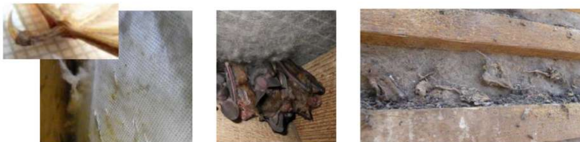
Figure 1 : les membranes respirantes en fibres de polypropylène non tissées (pare-vapeur) sont des pièges inextricables pour les chauves-souris. Source : Bruxelles environnement et Plecotus-Natagora.
