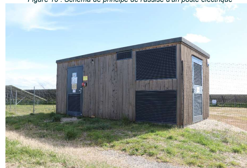
Figure 11 : Poste avec bardage bois
