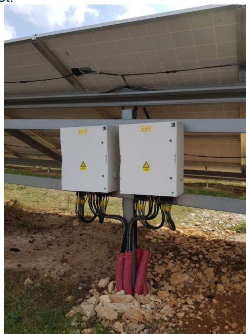
Figure 9: Onduleur string (source TSE)
