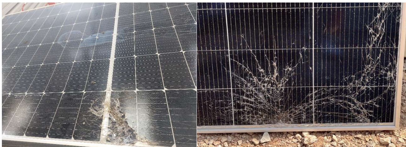
Figure 8 : Panneaux ayant subi un impact (source TSE)
