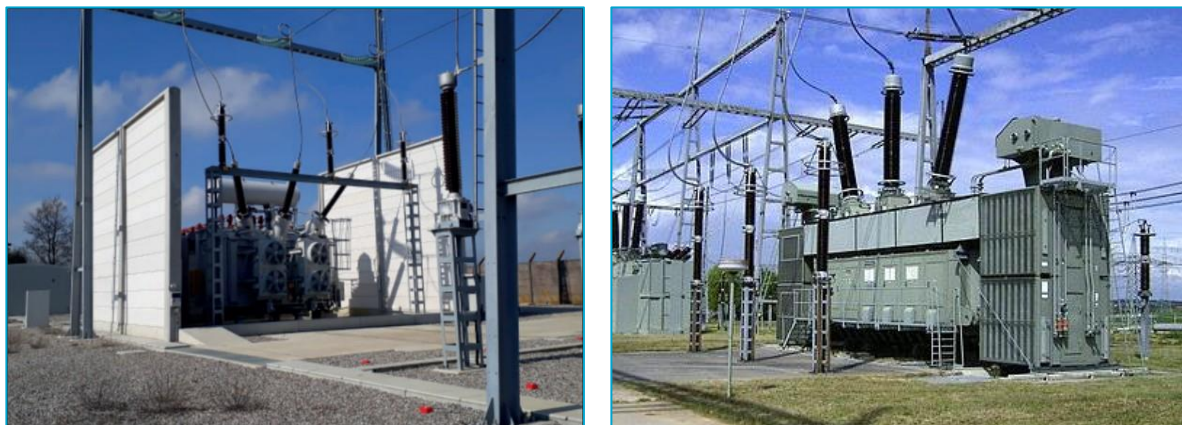
Figure 14 : Exemple des transformateurs de puissance, avec et sans mur d'enceinte, dans un poste très haute tension (Source : RTE)
