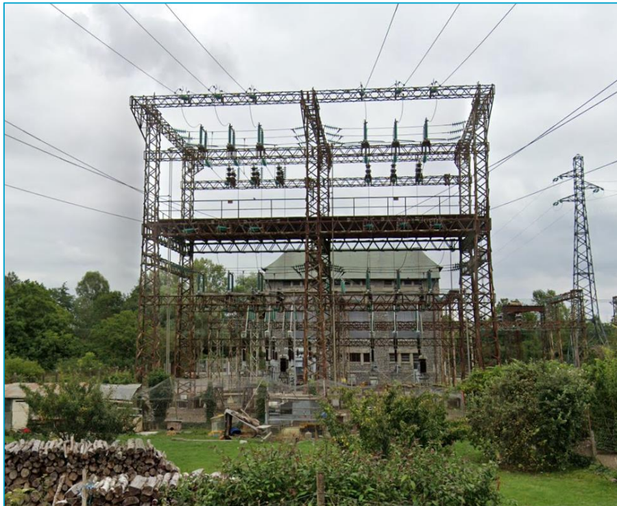
Figure 6 : Structure cathédrale du poste de MUSSAY
