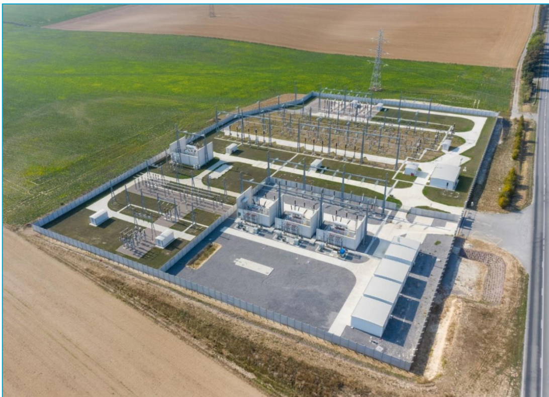
Figure 10 : Exemple du poste RTE 225 000 / 90 000 volts et du poste 225 000 / 20 000 volts d'Enedis de Le Hérie-la-Vieville (02 Aisne) (source : RTE)
