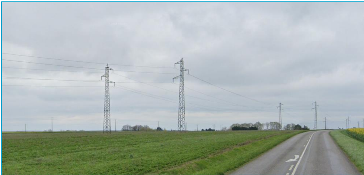
Figure 3 : Double ligne aérienne à 90 000 volts entre les postes électriques LE BOURG et VILLEMENT
