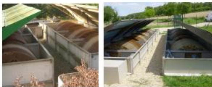
Figure 13 : Photographies de disques biologiques (EPNAC)
