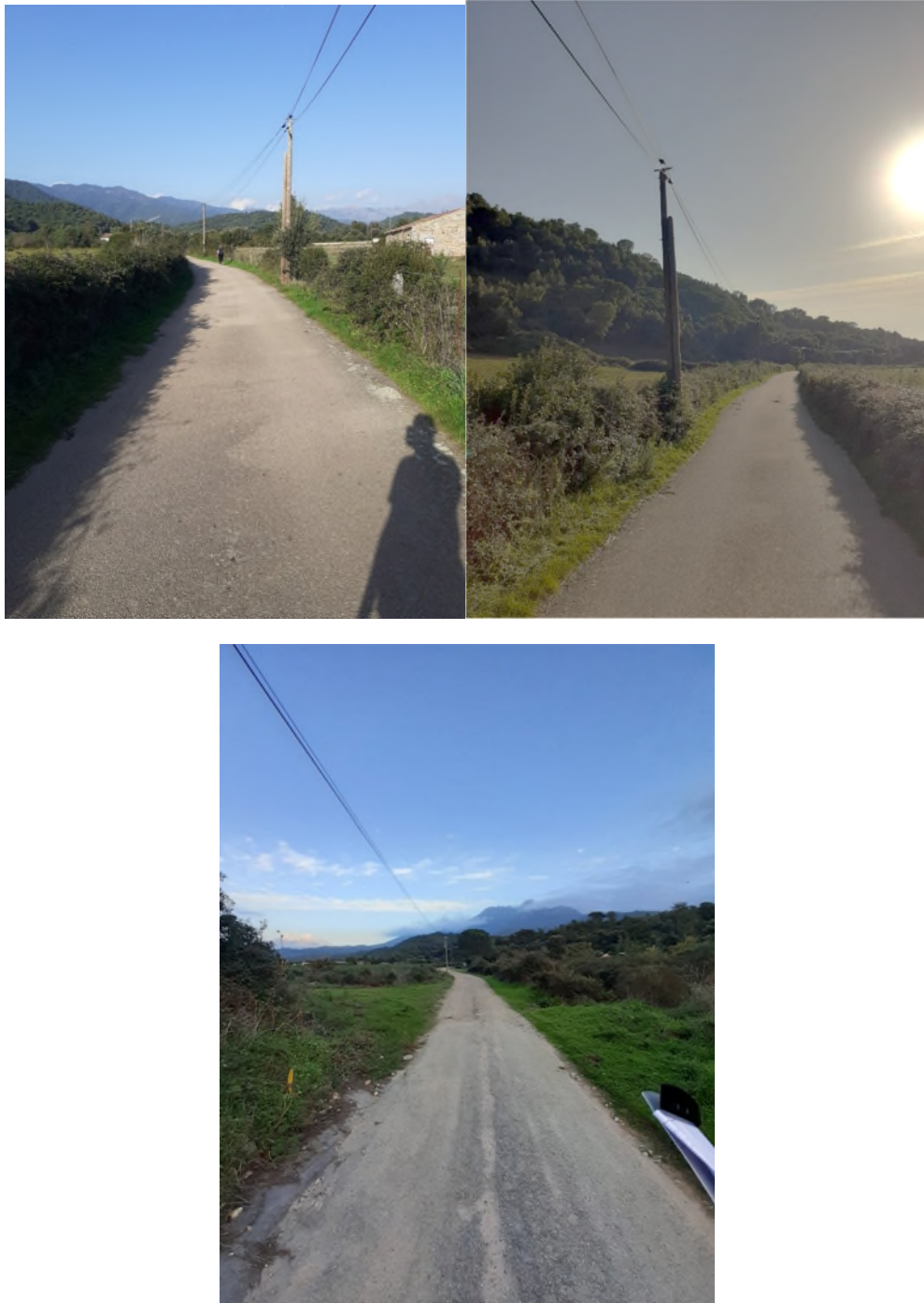
Figure 3 – Etat d'une partie de la route d'accès existante (photos prises par la MOE)
