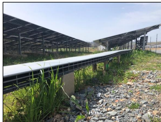
Figure 9 : Exemple de chemin de câbles en surface utilisé sur un autre projet SDMD (Réalmont, 81)
