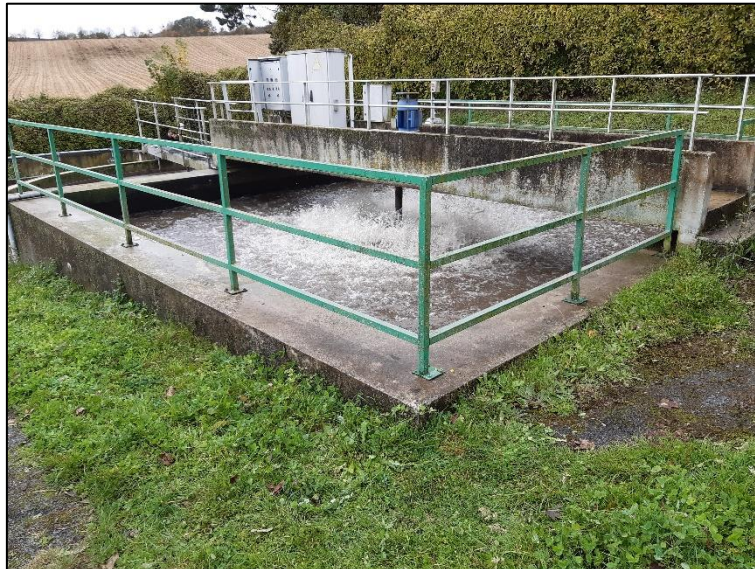
Figure 50 : Vue sur le bassin d'aération
