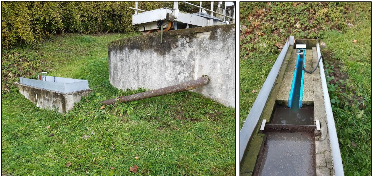
Figure 53 : Canal de comptage en sortie
