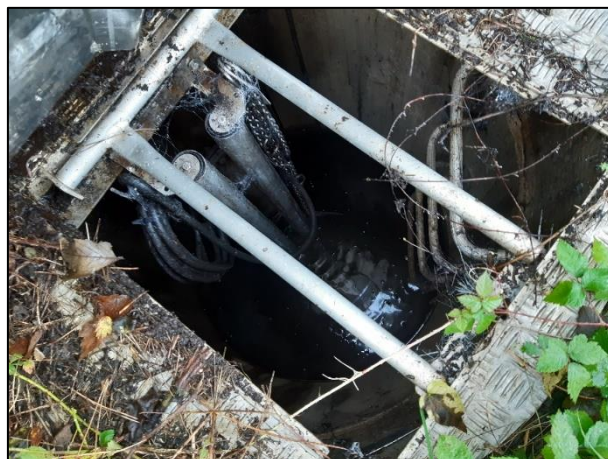
Figure 57 : Intérieur du poste de relèvement interne
