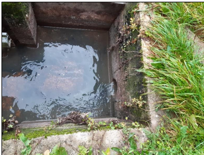
Figure 46 : Canalisations d'arrivée des effluents
