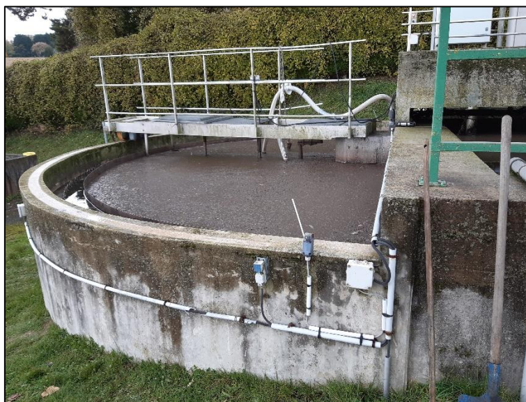
Figure 51 : Vue sur le clarificateur
