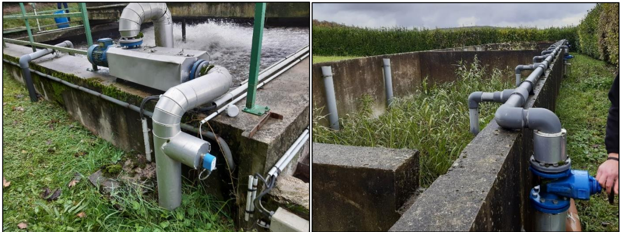
Figure 55 : Pompe d'extraction des boues et vanne manuelle de sélection des casiers en alimentation.
