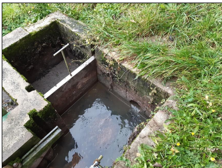
Figure 49 : Vue sur le by-pass entrée STEP
