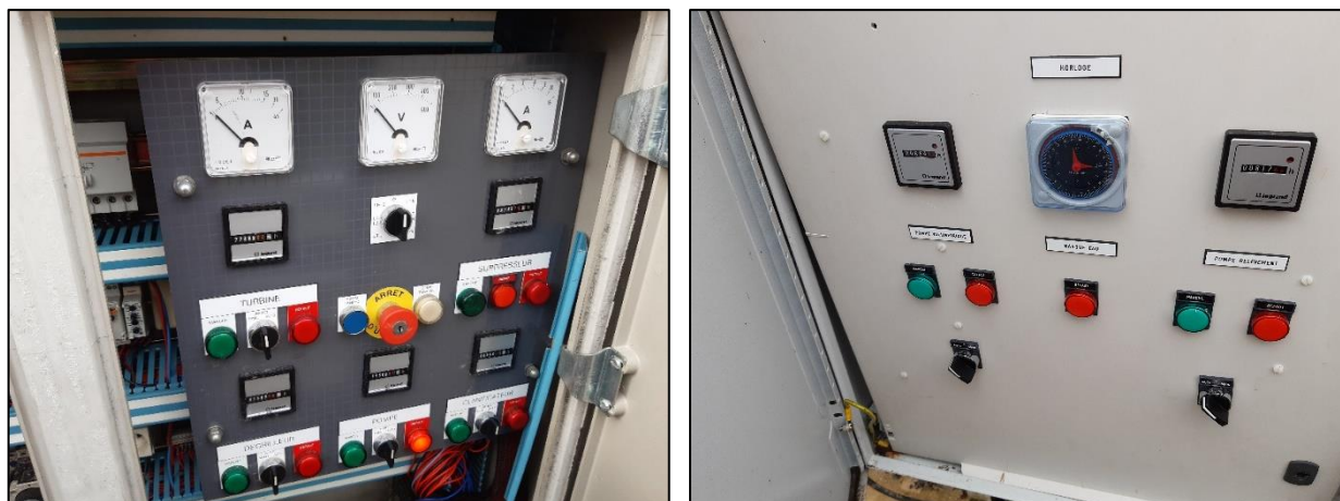
Figure 59 Façade des armoires électrique
