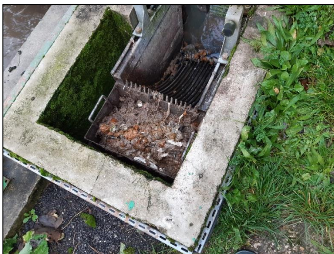
Figure 47 : Vue sur les refus de dégrillage
