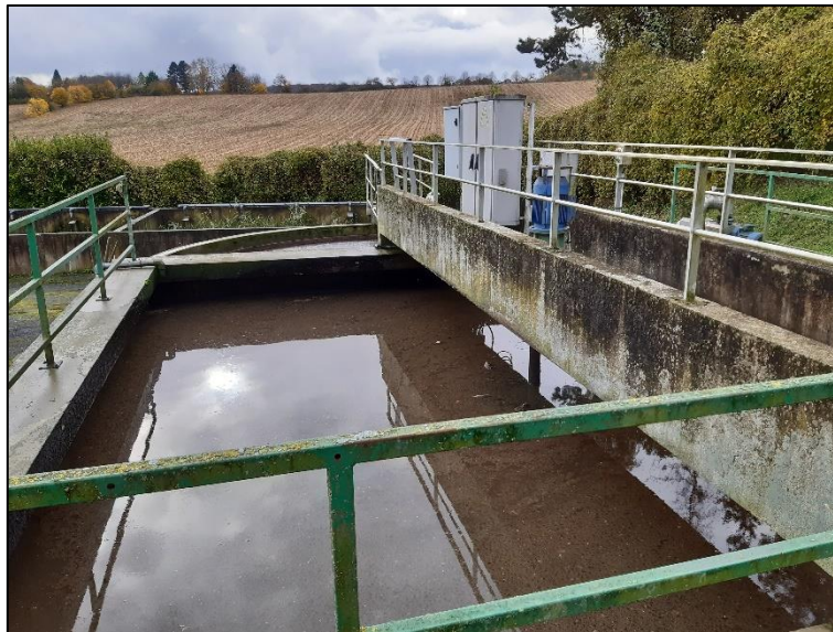
Figure 58 : Vue sur les armoires électriques installées sur la passerelle du BA
