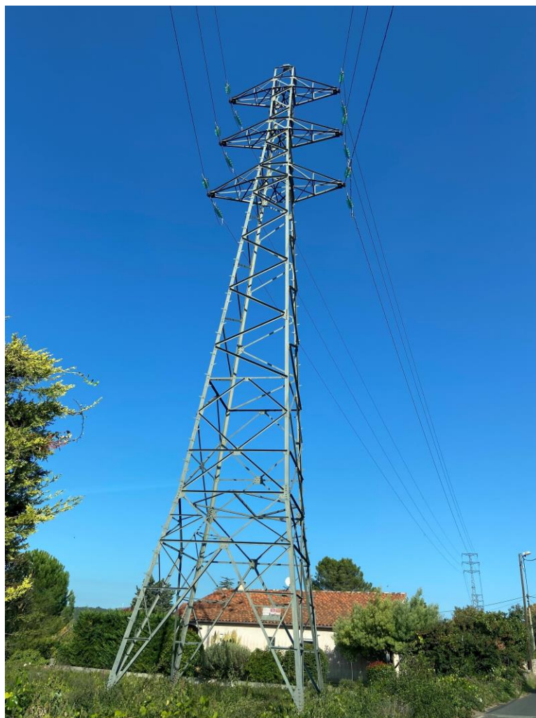
Figure 4 : Illustration des pylônes existants (source : RTE)
