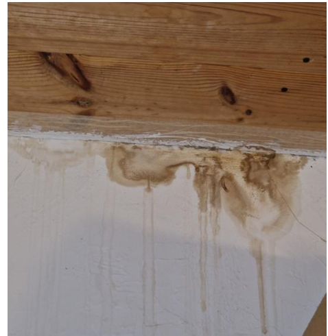
Photo 12 : Toiture non étanche de l'habitation
