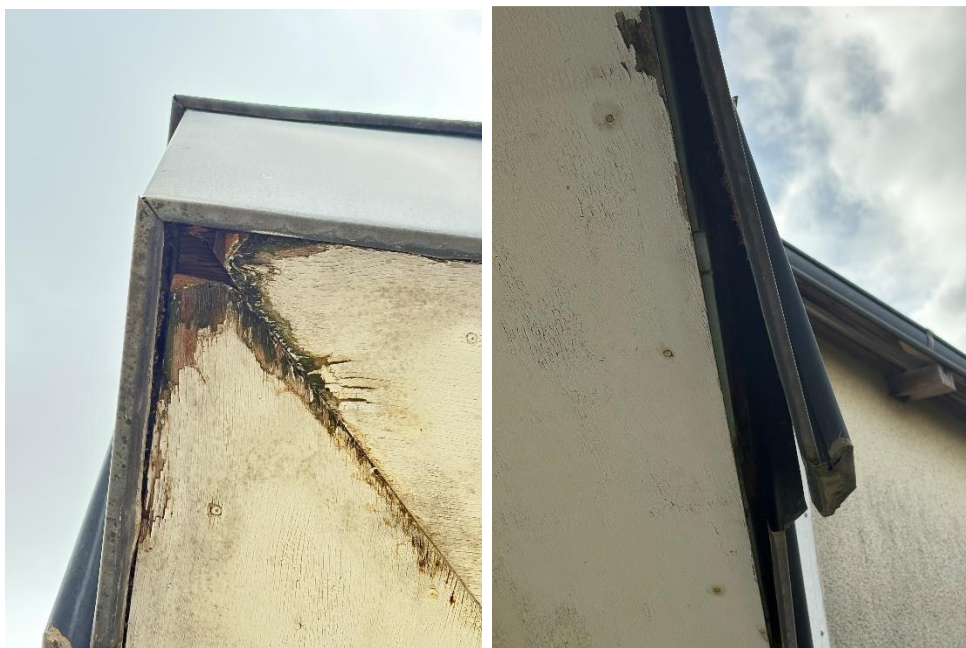
Illustration 1 : Anfractuosité dans la toiture et décollement
