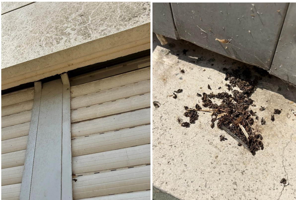
Illustration 4 : Ouverture au niveau des volets et indices de présence retrouvé à deux reprises
