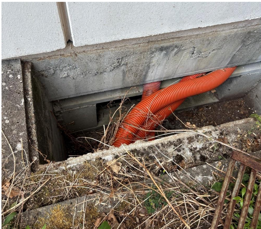
Illustration 5 : Ouverture pouvant amener à l'intérieur du bâti
