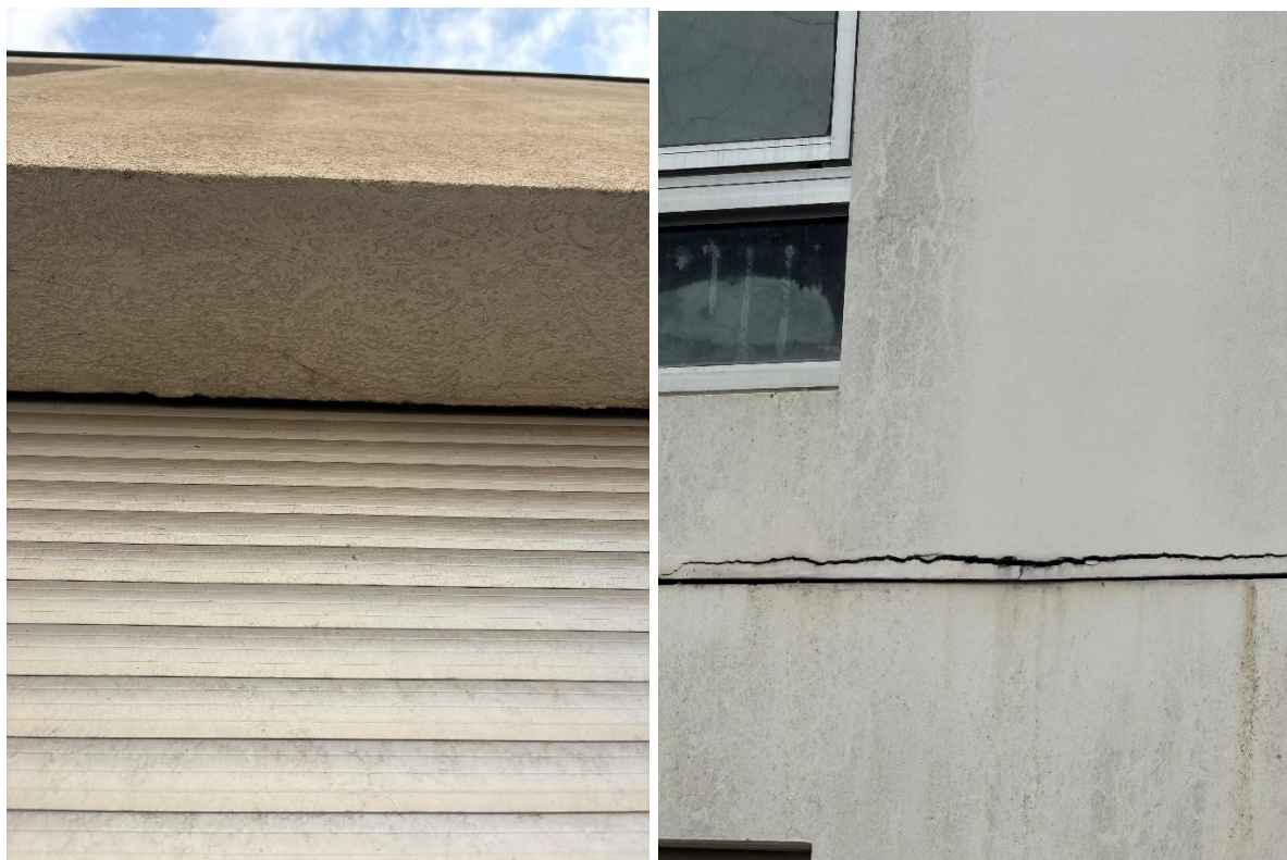
Illustration 2: Anfractuosité entre le mur et le volet (gauche) et fissure (droite)
