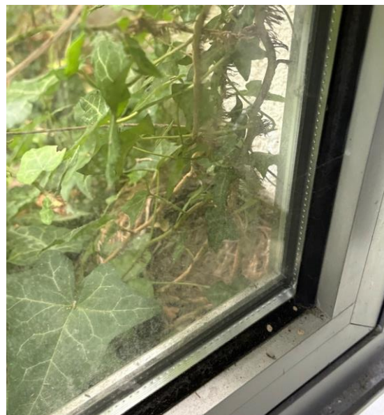
Illustration 12 : Nid observé sur le rebord d'une fenêtre d'un bâtiment
