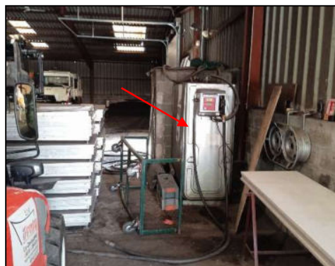
Cuve aérienne de gasoil
