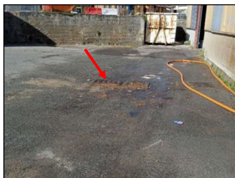
Zone de lavage 1
