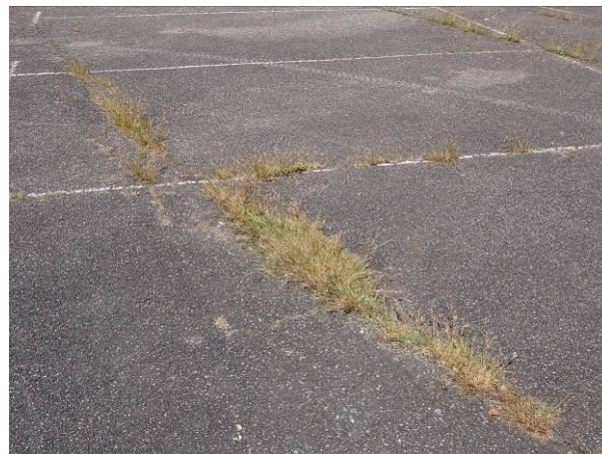
Fissures d'enrobé à Digitale sanguine
